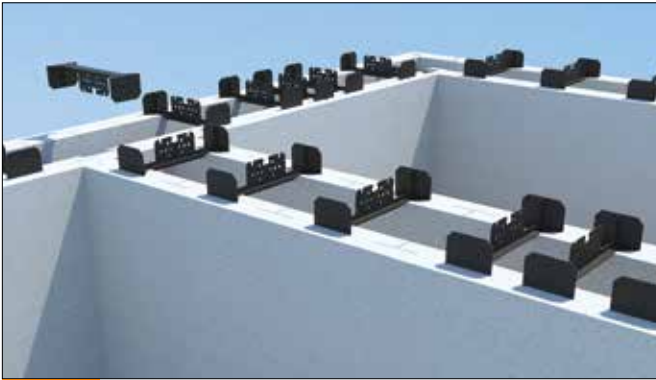
48 Pose des entretoises doubles et de l'entretoise simple à l'axe du mur de refend
