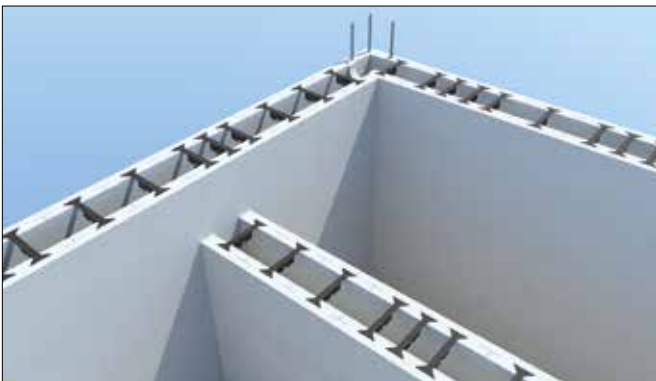
50 Pose des entretoises simple sur le dernier rang et sur le haut du mur de refend
